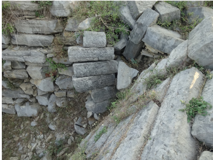
Figure 33 : maçonnerie non chaînée et reurement
