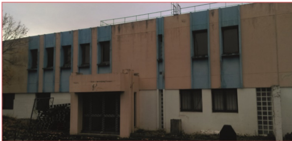
Figure 14 – Entrepôt vétuste à Aulnay-Sous-Bois, Source : Diagnostic Aulnay-sous-Bois, 2018
