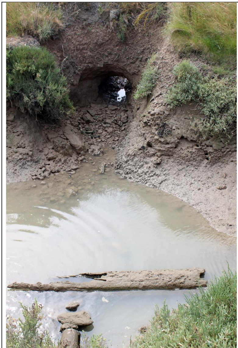
Fig. 5 : prise d'eau ayant chassé de son emplacement, structure 2 (B. Gissinger).
