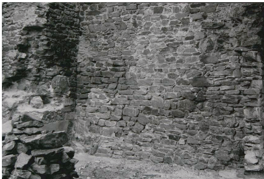
CR_022 : état avant restauration
