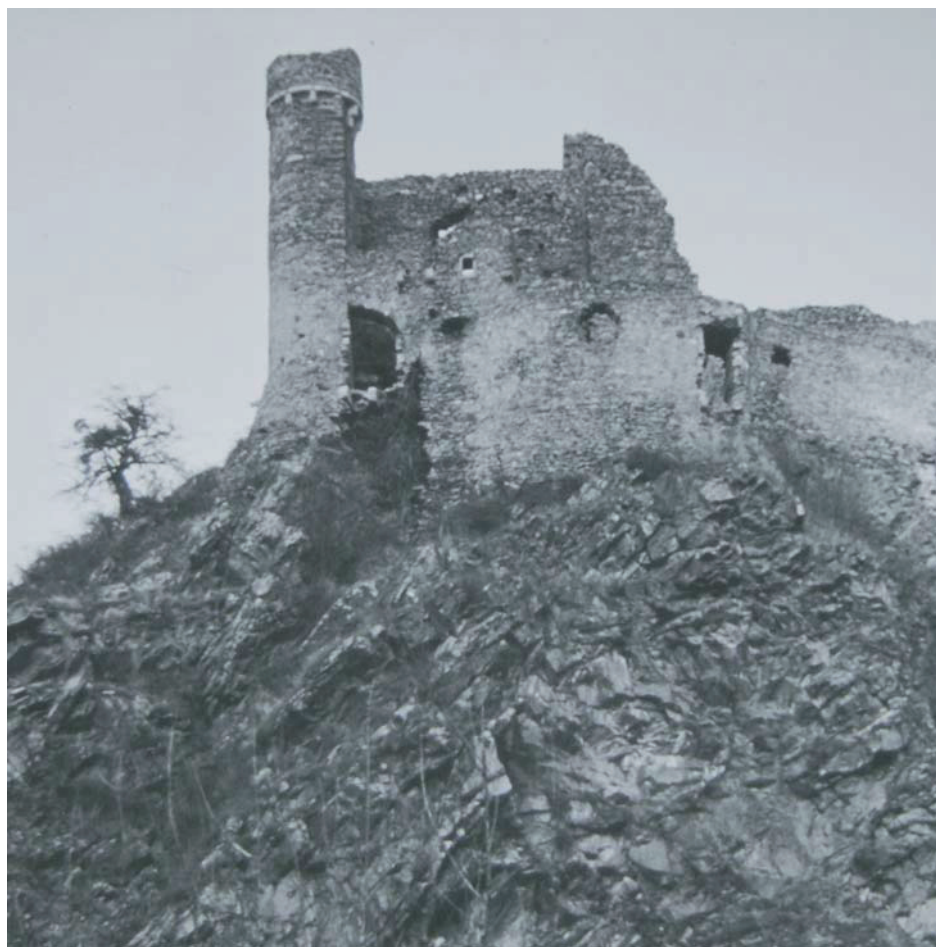
CR_007 : état avant restauration
