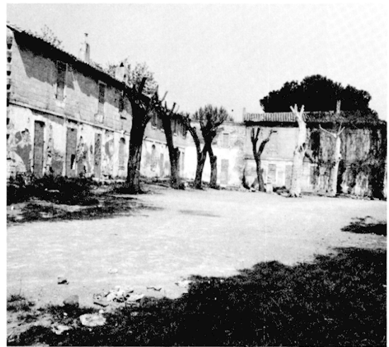
Fig. 3 - Vue d'ensemble des corps des bâtiments B et C prise de l'Ouest (document inventaire ; cliché Roucaute-Heller).
