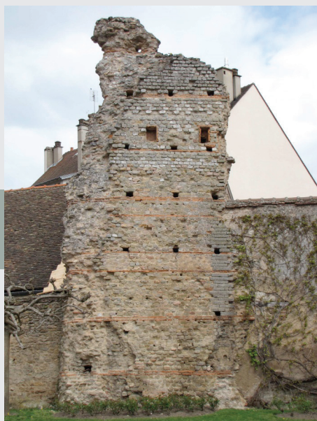
Fig. 1 Photo de la façade Sud du pan de mur (cl. L. Massot).
