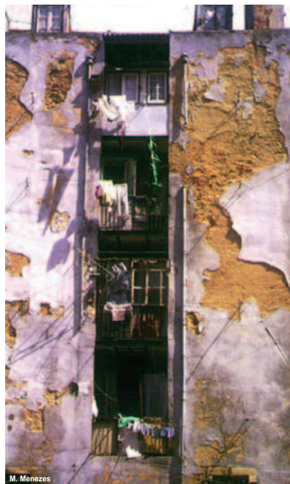
fig. 4 Immeuble dégradé du quartier de la Mouraria
