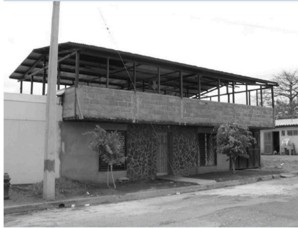
Figura - 3 Inmueble construido dentro del marco de un programa financiado por la Unión Europea según normas parasísmicas en el barrio de San Sebastián en el 2000. Un año más tarde, el propietario del inmueble ya había emprendido de manera completamente ilegal trabajos de ampliación, lo que hacía a su vivienda muy peligrosa en caso de sismo (Foto: S. Hardy 2001).
