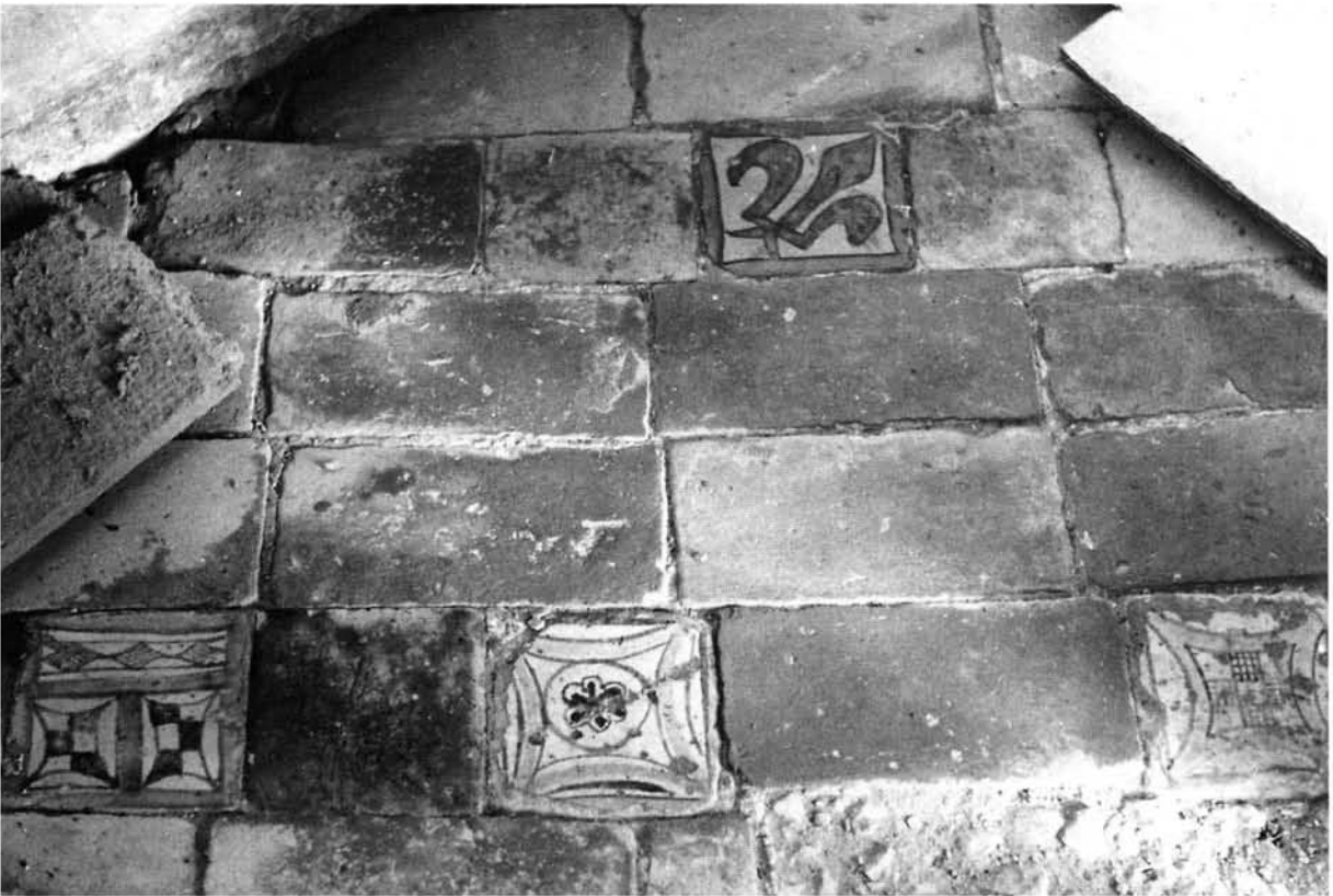
138 - Studium de Benoît XII, réparation tardive avec des carreaux rectangulaires et réemploi de carreaux calcaires.
