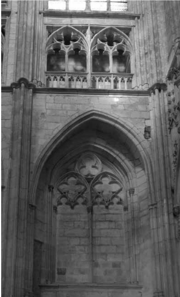
Fig. 9. Mur gouttereaux des collatéraux Nord: fenêtre aveugle. Rainure originelle de la fenêtre. Cl. H. Hansen.
