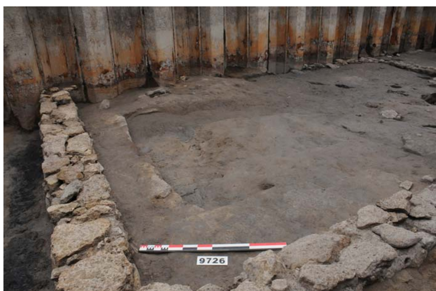
■ Fig. 92 : Vue depuis le sud-ouest, de la maison en construction (UNF143) de la phase 1S, avec des amas de terres de nature différente (limon, argile, terre malaxée) liées au chantier.
