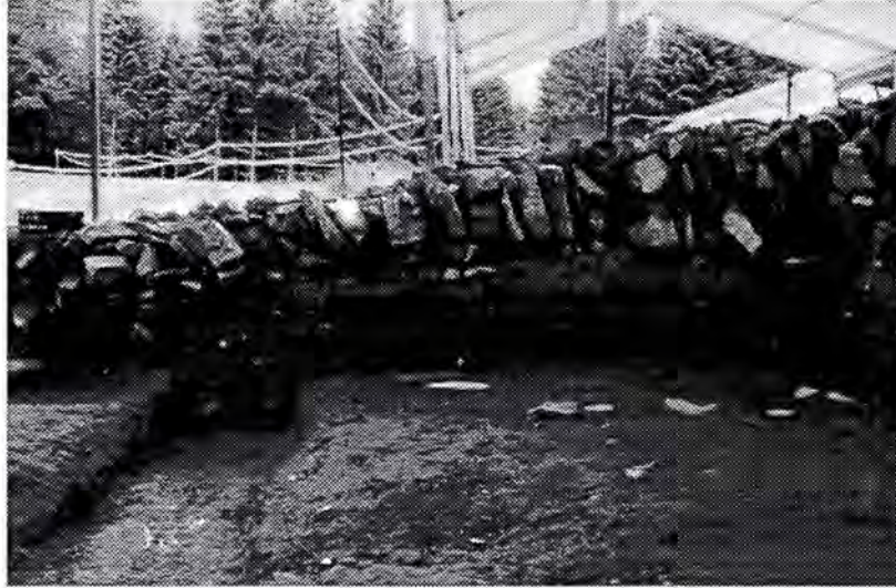
2 : coupe transversale du mur effondré
