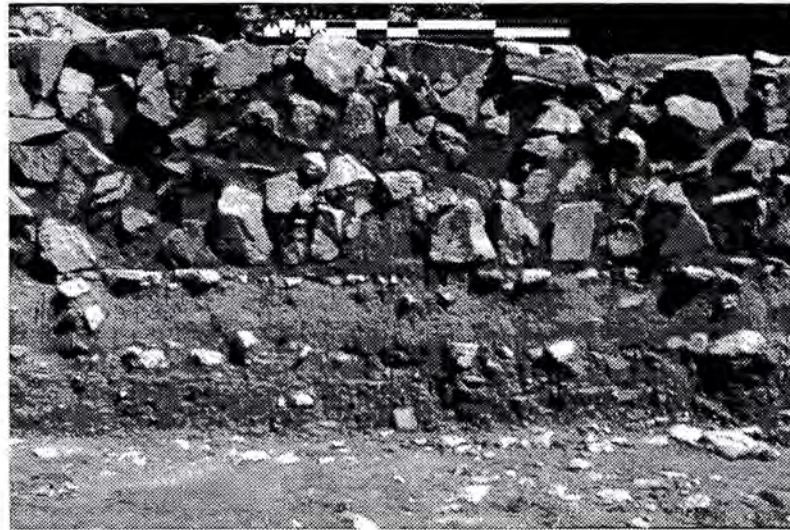
3 : coupe longitudinale de la rue et du mur effondré
