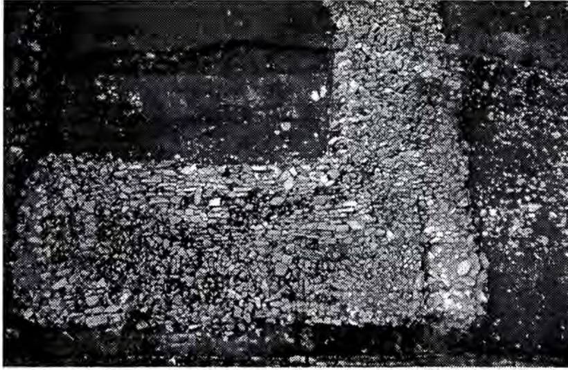
1 : vue zénithale du mur effondré
