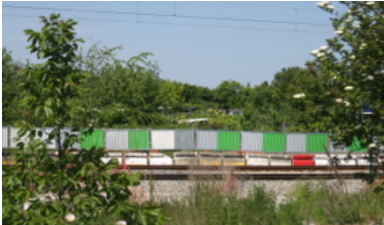
Vue vers les jardins de Villeteuse (site02), de l'autre côté de la voie ferrée en cours de travaux pour la création de la Tangentielle Nord – source : Cerema, mai 2014
