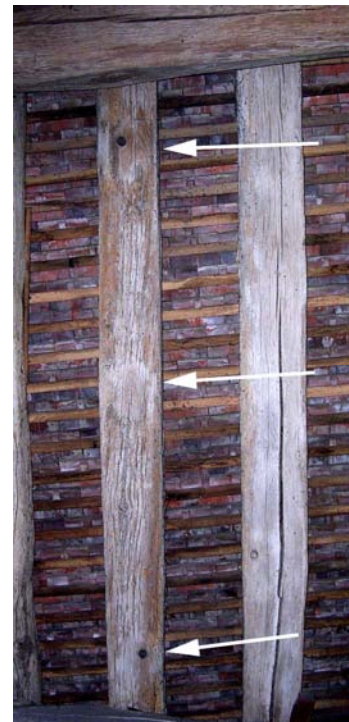
Lierne réemployée avec l'empreinte des faux entrails, chevillés une ferme sur deux, posés sur sa face supérieure
