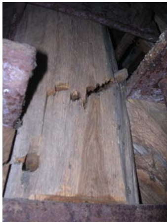
"Déchirement" du poinçon lié au surpoids de la ferme
