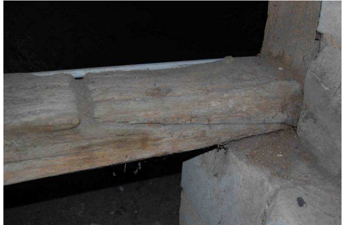
Fig. 61 : Sablière interne du collatéral nord, et son enture oblique à talons biais maintenue par quatre fortes chevilles.
