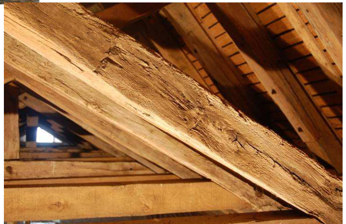
Fig. 17 : Entailles d'ébauchage sur une écharpe du croisillon nord.
