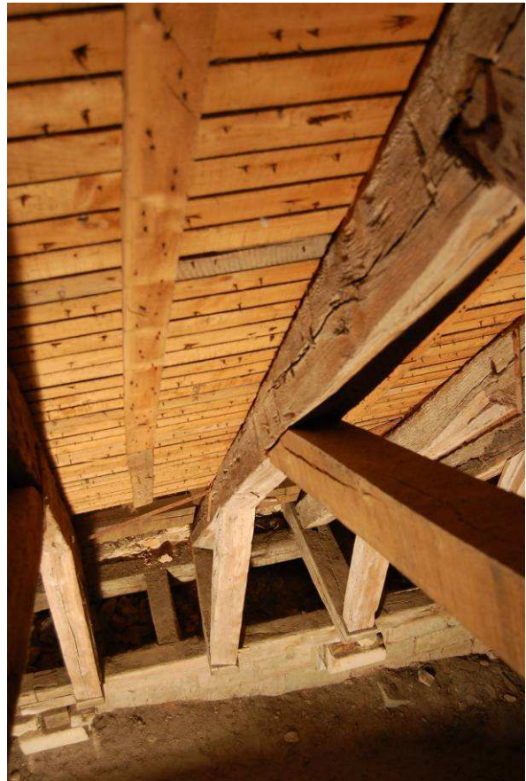
Fig. 8 : Chevron de F19 du croisillon sud qui a vrillé après sa mise en place, entraînant la jambe de force et le blochet.
