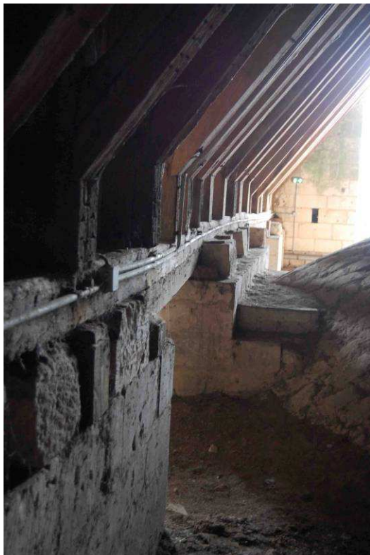
Fig. 60 : Déformation des sablières récentes sous la poussée des demi-fermes du collatéral sud.
