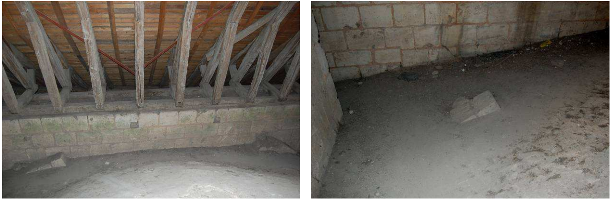
Fig. 36 : Départs d'arcs de décharge contre le mur est et sud.
