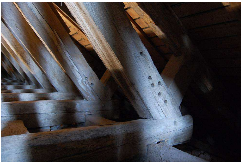
Fig. 44 : Trous de cheville sur la face sud des chevrons.
