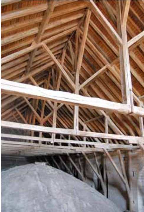
Fig. 32 – Charpente du vaisseau central de la nef, vue depuis l'ouest, cl. Frédéric Épaud.
