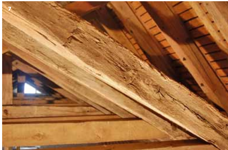
Fig. 6 – Chevron de F19 du bras sud qui a vrillé après sa mise en place, entraînant la jambe de force et le blochet, cl. Frédéric Épaul.
