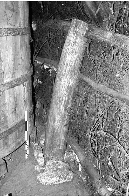
Fig. 28 Ambillou, « La Giberdière ». Poteau planté, avec pierres de calage en pied, déversé sous la poussée des fermes (cl. F. É.).
