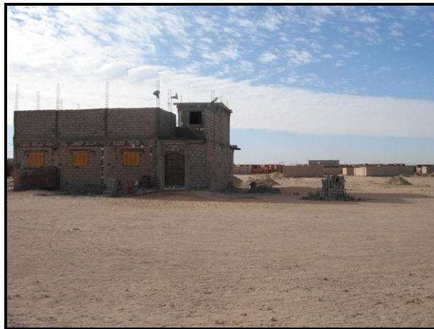
Photo n°4. Coopérative immobilière à Adrar (Cheik-Mohamed-Ben-Lekbir) : retard flagrant dans la construction (excepté une salle de prière destinée pour la cité des logements sociaux et LSP)
