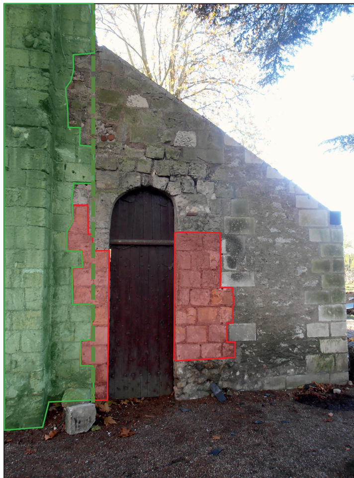
Fig. 17 : mise en évidence du pignon nord de l'aile des convers accolé à l'angle nord-ouest du réfectoire, subsistant dans une maçonnerie plus récente (photo prise en novembre 2013, pendant la démolition de l'appentis contemporain flanquant le pignon ouest du réfectoire)
