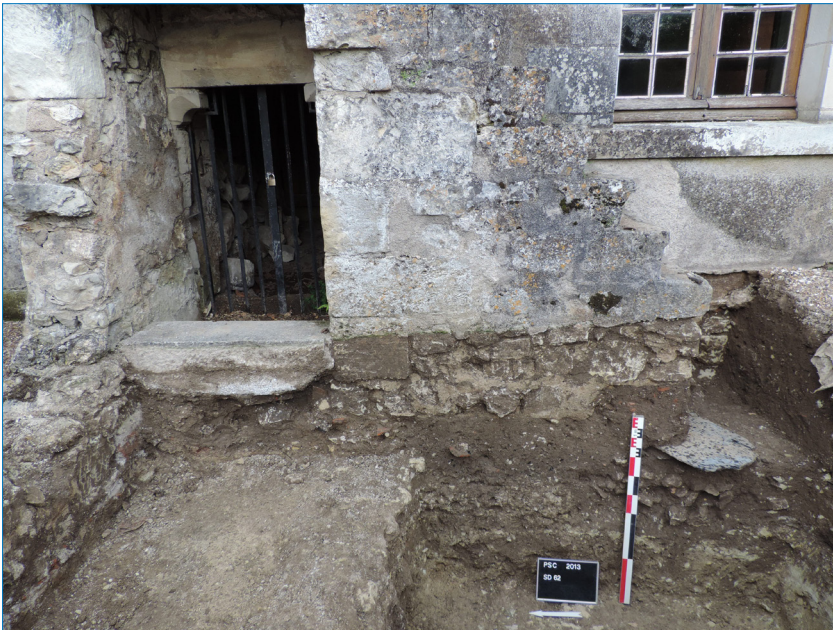
Photo 37 : le sondage n°62, au pied de l'escalier F1396 situé à l'angle nord-ouest du logis du prieur (vue vers l'est)
