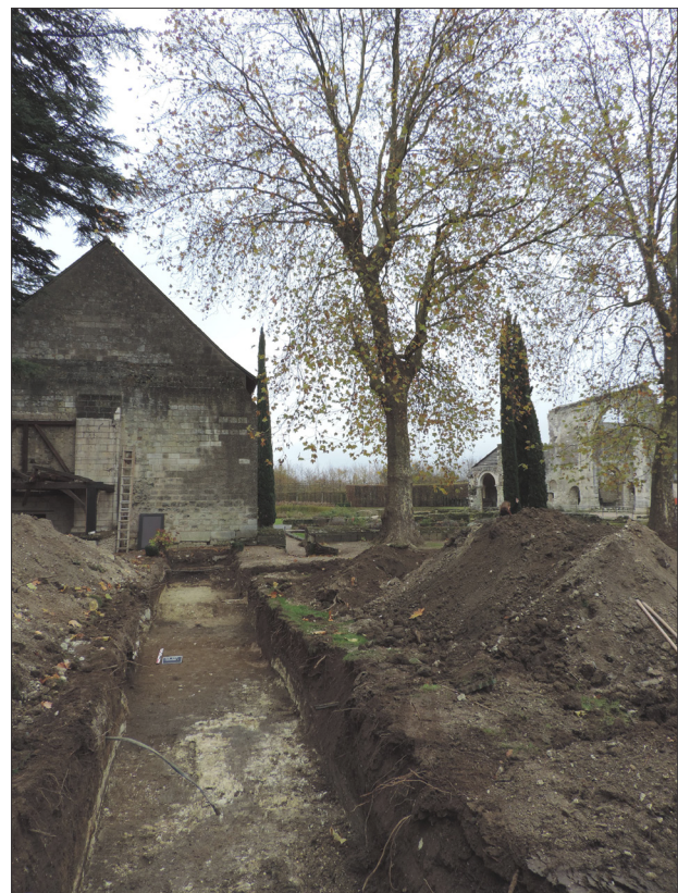
Photo 16 : la tranchée T1, partie est (au fond, le pignon ouest du réfectoire des moines)
