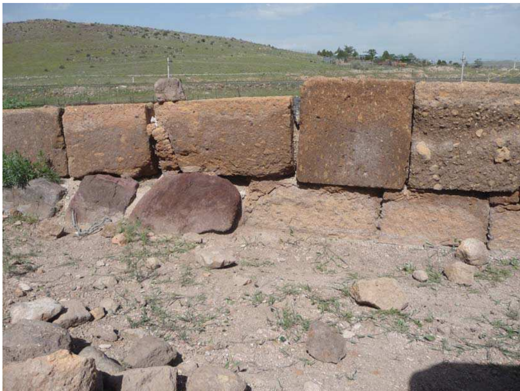
Fig. 38 – Ereruyk. Enceinte orientale. Face ouest du mur MUR 1200. Cliché : A. Hartmann-Virnich (LA3M, 2014).
