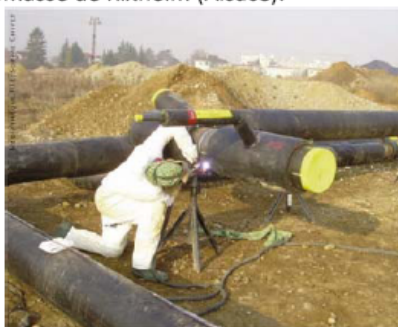
Photo 1. Préparation de canalisations pré-calorifugées pour le réseau de chaleur branché sur un doublet géothermique couplé à une chaufferie bois (Source Médiathèque RTE)
