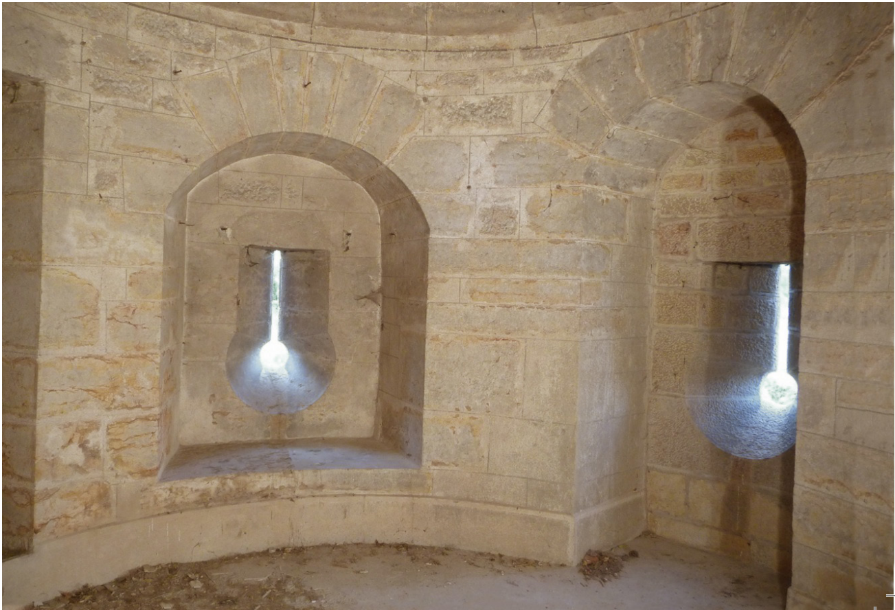
Fig. 16 : deuxième niveau, archère-canonnière d'origine (à gauche) et niche d'une ancienne baie remplacée par une archère-canonnière pastiche (à droite). (Cl. R.P.L.)
