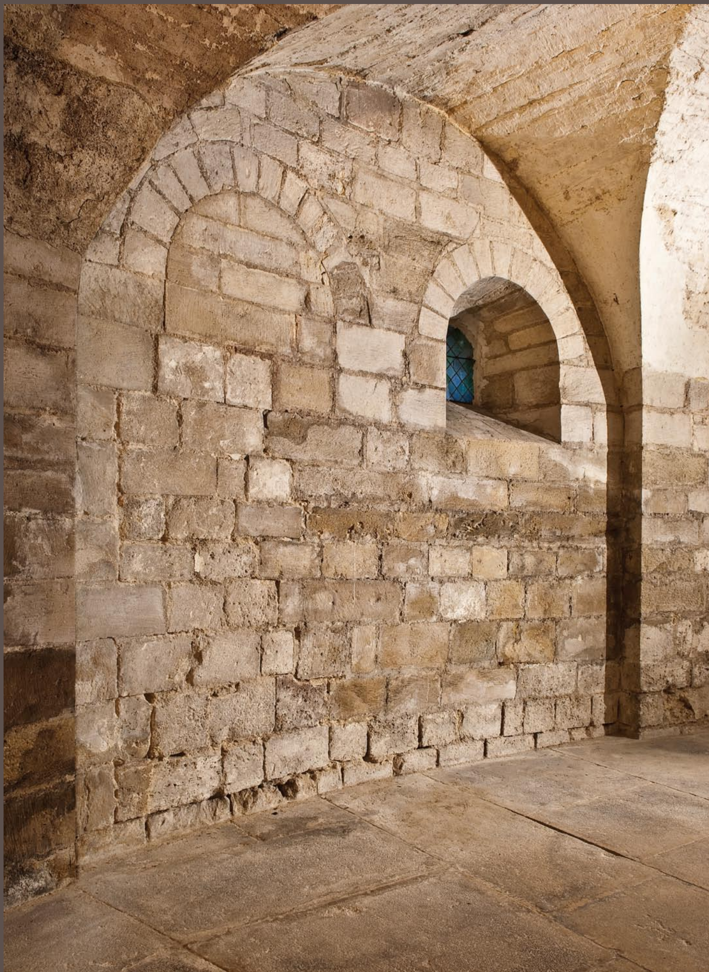
Fig. 11 Vue des accès bouchés et restaurés menant de la crypte au palais épiscopal (cl. G. Puech).
