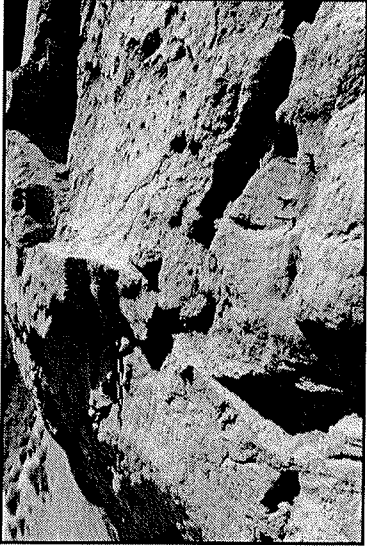
Fig. 63: Khaytabad, citadelle: la courtime du dernier état entaillée par la pièce 1 dont le sol est marqué de fissures concentriques.
