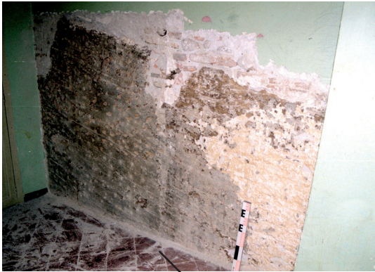
2 bis : Parement du mur MR508 : traces des planches obliques du coffrage (I. Rémy, INRAP)
