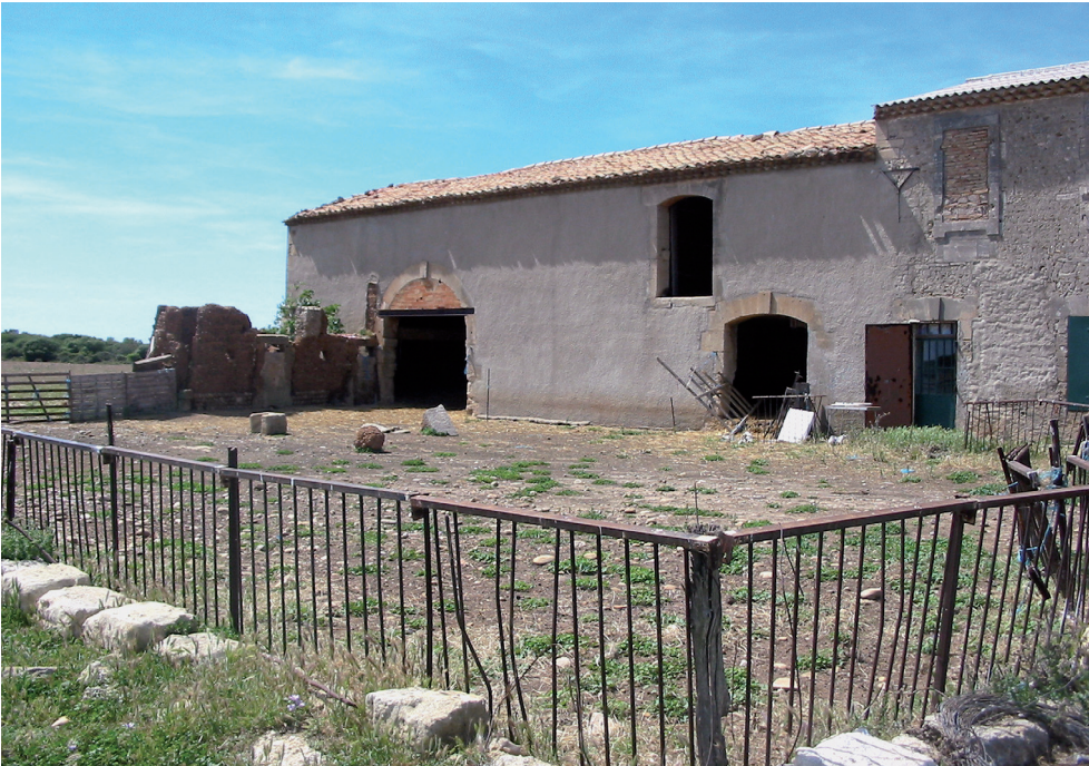
Fig. 21 : Arles (13), bergerie de Négreiron. Construction en pisé, datée vers 1900, masquée par un enduit au ciment (H. Gazzal)
