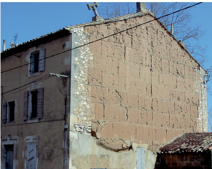
Fig. 20 : Plan d'Orgon (13). Maison urbaine en pisé dans un faubourg du XIX e s. (C.-A. de Chazelles, CNRS)
