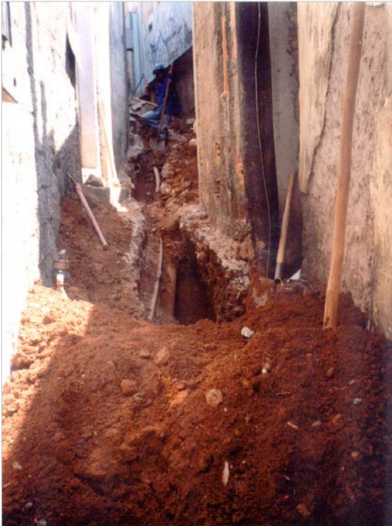
Figure 7: Exemple de travaux d'assainissement dans les favelas effectués d'après l'OP bassin versant Vitoria (photo COPASA 2005).
