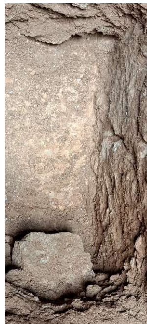
Fig. 51. Détail de la roche sur laquelle est fondé le mur. Vue vers l'Ouest.
