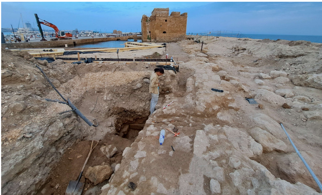
Fig. 75. Sondage contre la face Nord du rempart, sous les couches de pierraille et de décharge modernes. Vue vers l'Est.
