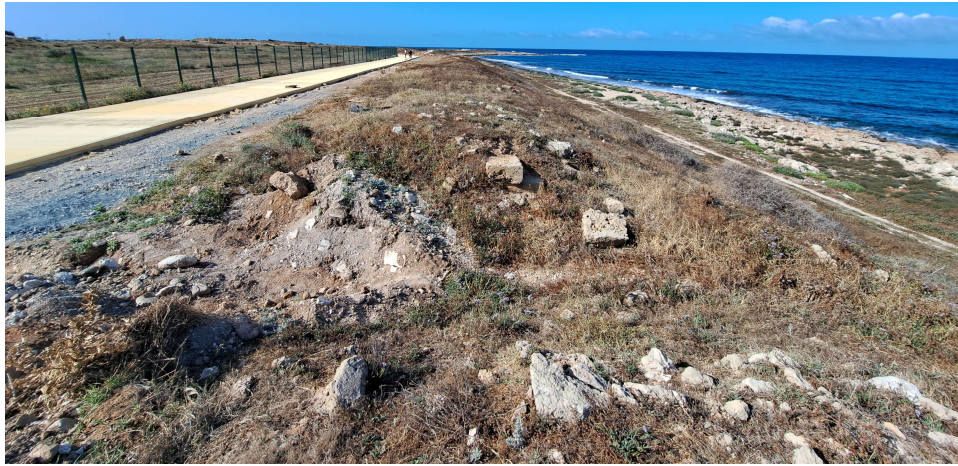
Fig. 13. Le rempart Ouest endommagé par une brèche. Vue vers le Sud. Cliché : MafaP/C. Balandier.
