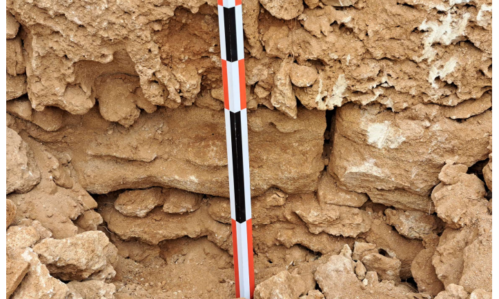
Fig. 22. Bloc érodé et pierres de calage en dessous.
