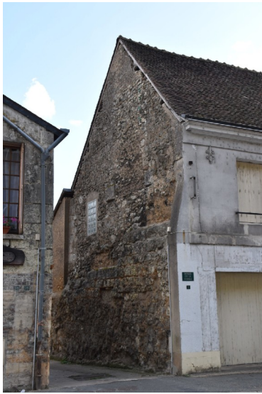
Figure 76 : Mur nord du bâtiment 1 impasse de la Forge aux Roches (corpus 0712)
