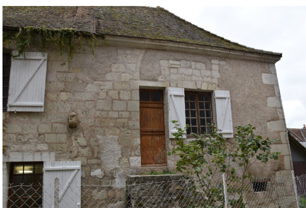
Figure 36 : Prieuré de Lunay : Façade sud du bâtiment Est, avec un grand arc écrivé par la destruction du pignon sur rue
