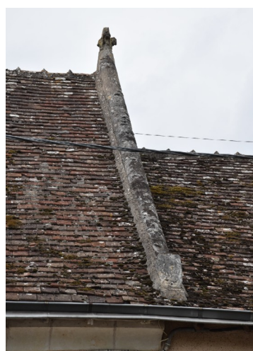
Figure 19: Exemple de rampants chanfreinés endommagés prenant une forme arrondie (corpus 1045)
