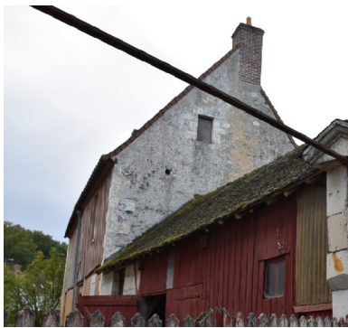
Figure 93 : Maison en pierre et pans de bois rue d'Amboise à Saint-Arnoult (corpus 1204)
