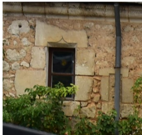
Figure 184 : Ensemble bâti 1052, Baie à accolade du corps joignant la tourelle d'escalier
