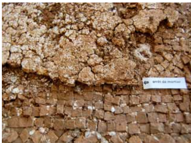
Fig. 10 Identification des arrêts d'enduit sous les caissons (photo ACRM).
