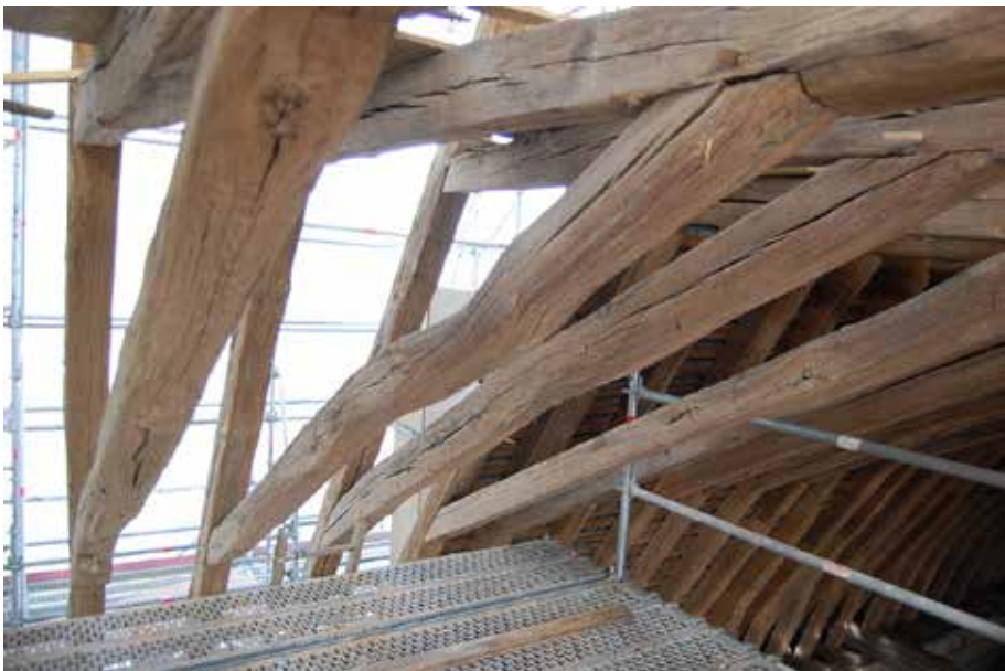
Figure 2 : Charpente de la cathédrale de Bourges de 1258. Bois de brin équarris à la doloire, légèrement courbes et présentant de l'aubier aux arêtes (cliché F. Epaud).
