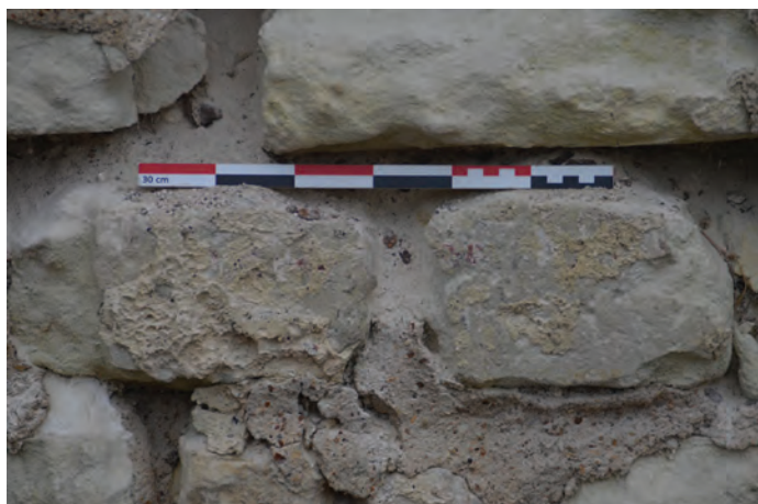
d - enduits et traecs de peinture sur le parement sud de M.6003 (pilier est)
