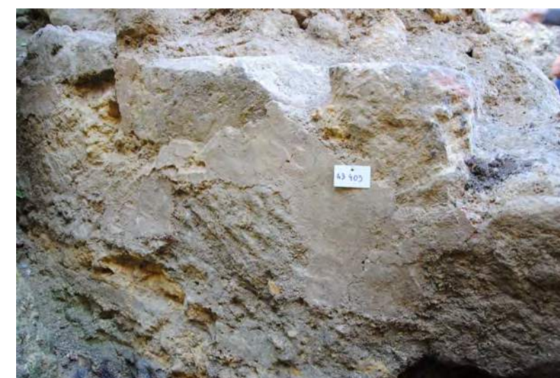
c. Détail de l'enduit présent sur la face interne du mur M.1036 (1).
