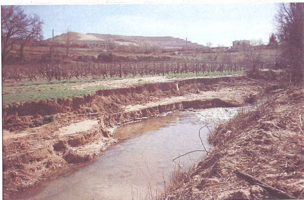
Photo n° 12 : Les érosions de berges attaquent de préférence des tronçons dégarnis de leur végétation Rivière Auzon (Vaucluse) janvier 1994.
