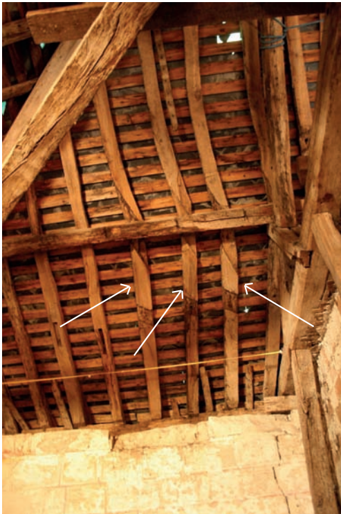
4. Echarpes réemployées comme chevrons. la difficulté de mise en place des bois courbes est montrée par les écarts très différents entre les entailles.
