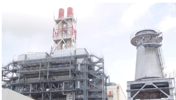
Photo 7 : La centrale de Pointe des Carrières à Fort-de-France. Auteur : François Ory, 2018.
