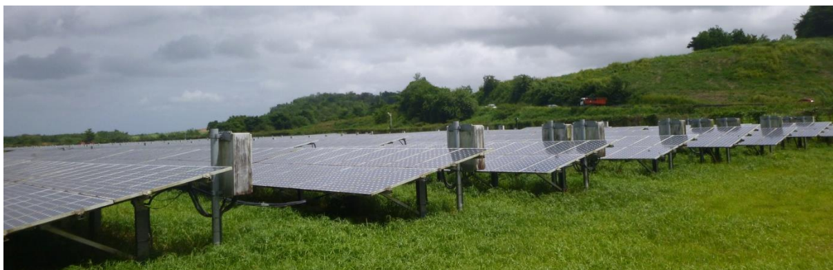
Photo 22 : Photovoltaïque au sol dans la commune de Ducos.
