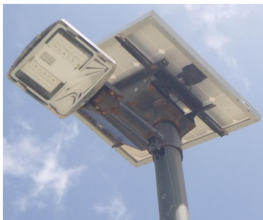
Photo 5 : Lampadaire autonome sur la commune du Vauclin. Auteur : François Ory, 2017.
