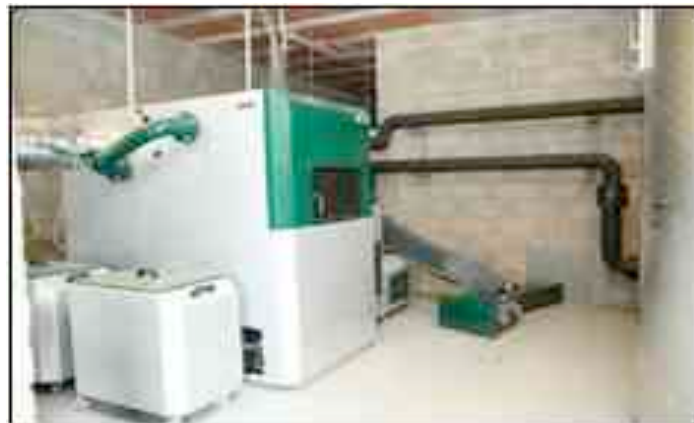
Photo 123 – Chaudière biomasse du CTFC
