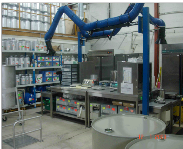
Photo 54 (gauche) – Unité de préparation des commandes, usine IFF/LMR (Grasse, France)
