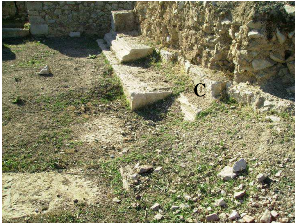
Photo 175 : Façade latérale sud arrachée partiellement et montrant le remplissage massif du podium du temple C.
