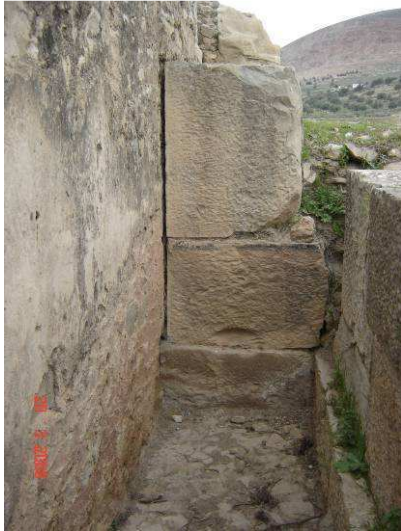
Photo 162: Raccordement du mur de fond à celui de la cella centrale du temple sévérien.
