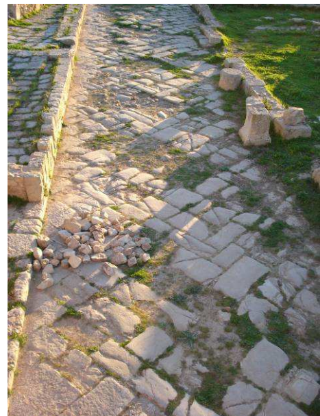
Photo 130: Etat du dallage de la rue dans son tronçon à l'ouest du théâtre.
