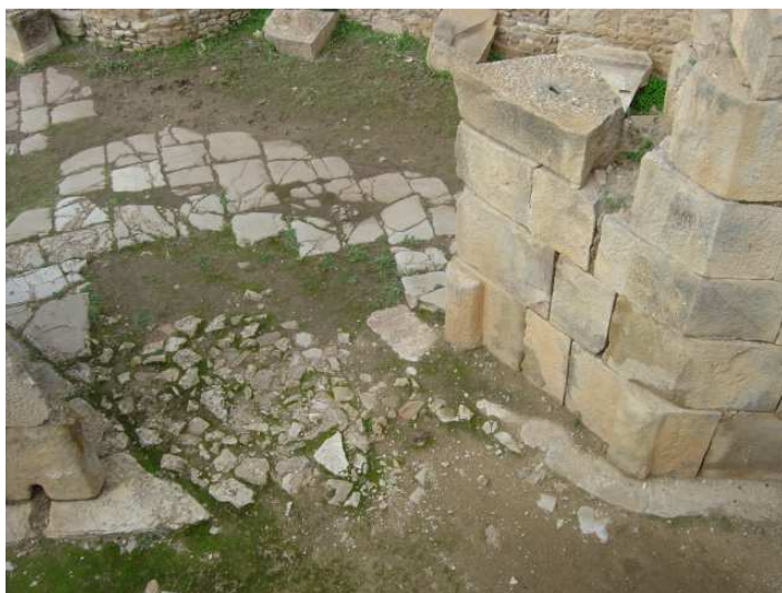
Photo 7: Etat du dallage de la travée 4.
