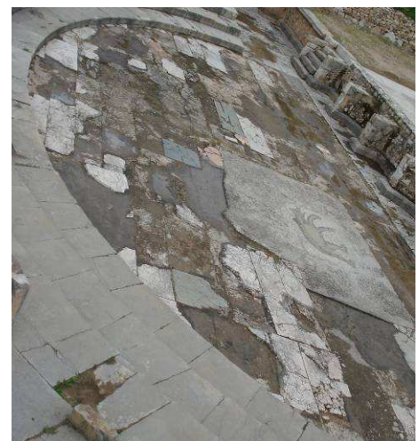
Photo 87 : Etat du revêtement de l' orchestra .
