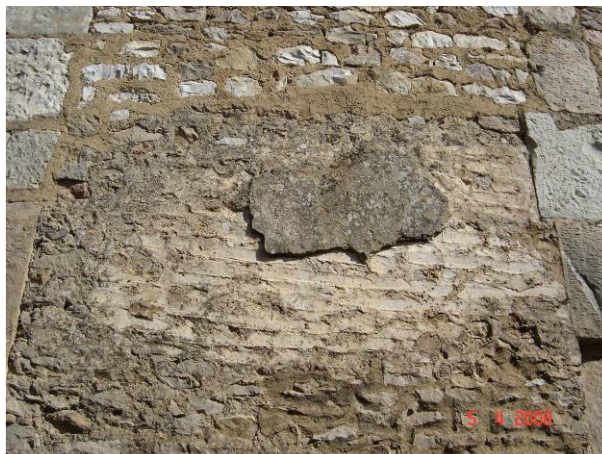
Photo39 : Traces de l'enduit du mur m3 et aspect de la couche d'accrochage de l'enduit.
