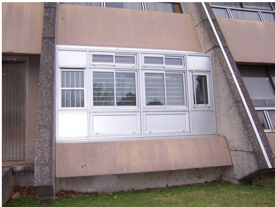
Figure 4-1 : façade extérieure de la cellule Hybcell
