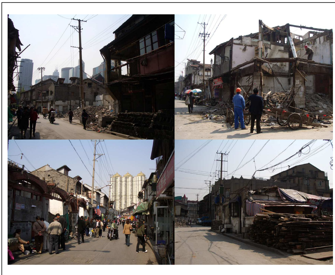
Photo 11 : La démolition de la Fang Bang Zhong lu au sein de la zone Xiangyuan Lu
