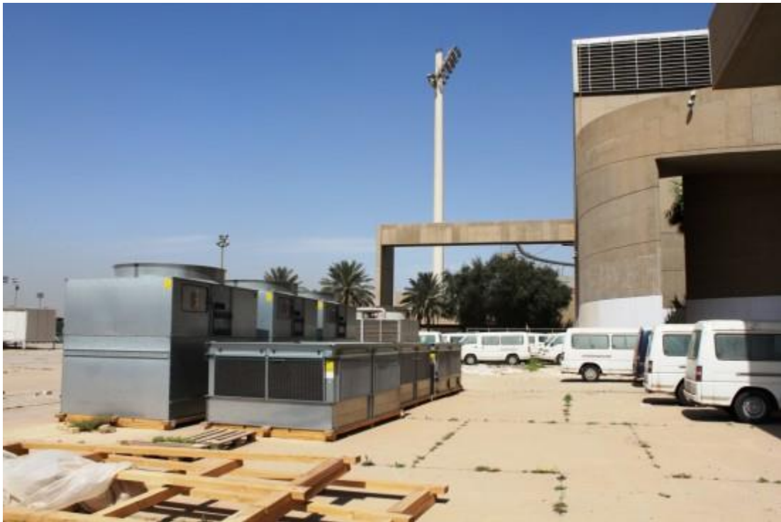
Fondation Le Corbusier/ ADAGP/ Caecilia Pieri, 2012. Modifications dues à la rénovation actuelle : devant la façade, bouches d'aération pour l'air conditionné.
