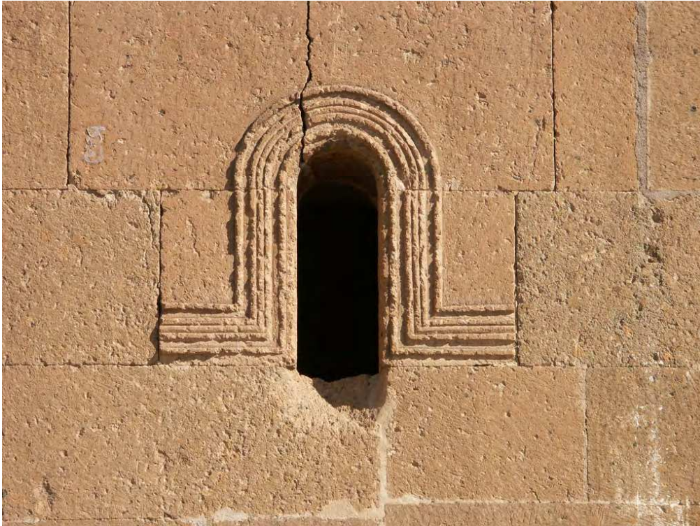
Fig. 128 – Façade sud, fenêtre de la sacristie sud-est. Cliché de P. Donabédian, CNRS-LA3M/UMR 7298, 2013.
