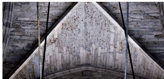
Figura 10. Desórdenes constructivos. Diferencia en el tratamiento de los paramentos exteriores: A. Tramo 7, nave oeste. B. Tramo 19, nave este. C. Tramo 22, plemento de bóvedas relleno de ladrillo (daños observados en los tramos de la nave este antes de su restauración).
