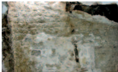
Figure 5. Bauge, lits de terre et rangs de brindilles. Béziers, France, XIV e s. (C.-A. de Chazelles).
