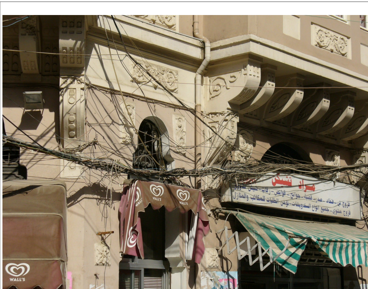
Figure 1 : Enchevêtrements de fils électriques de générateurs à Beyrouth © E. Verdeil
