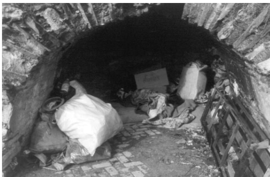
Niche transformée en poubelle sauvage
